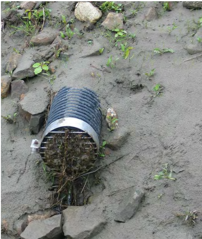
Photo 3 : Grille partiellement obstruée Source : Mikael Guillou (MAPAQ)
