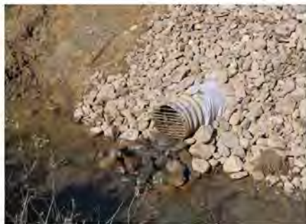
Photo 1 : Sortie de drain avec grille amovible Source : Régis Patvin (MARAQ)
